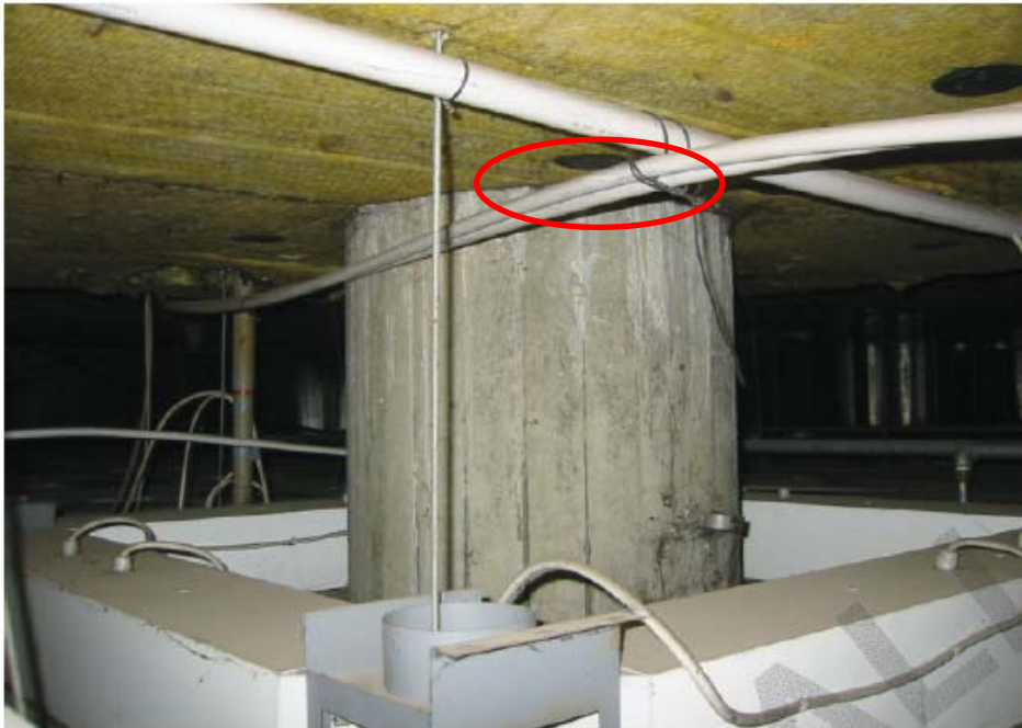
Bild 5 Blick in den geöffneten Hohlraum der abgehängten Decke. Die ungedämmte Betonstütze durchdringt die Wärmedämmung an der Unterseite der Decke vom 1. OG nach unten zur ebenerdigen Tiefgarageneinfahrt. Quelle: [5].
