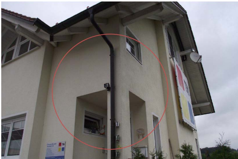
Bild 1 Außenansicht der Ecke mit nicht durchgehend geführter Dämmebene. Die Ecke wird gebildet durch das Zusammentreffen der 3 Kanten Außenwand/Außenwand, seitliche Außenwand/Decke über Eingang, Giebelwand/Decke über Eingang. Die Stütze durchdringt die Dämmebene im Bereich der Ecke; sie stellt den 4. Aspekt dar. Für diese Ecke ist ein dreidimensionaler rechnerischer Nachweis erforderlich, um den Nachweis Schimmelkriterium zu erbringen. Quelle [4].
