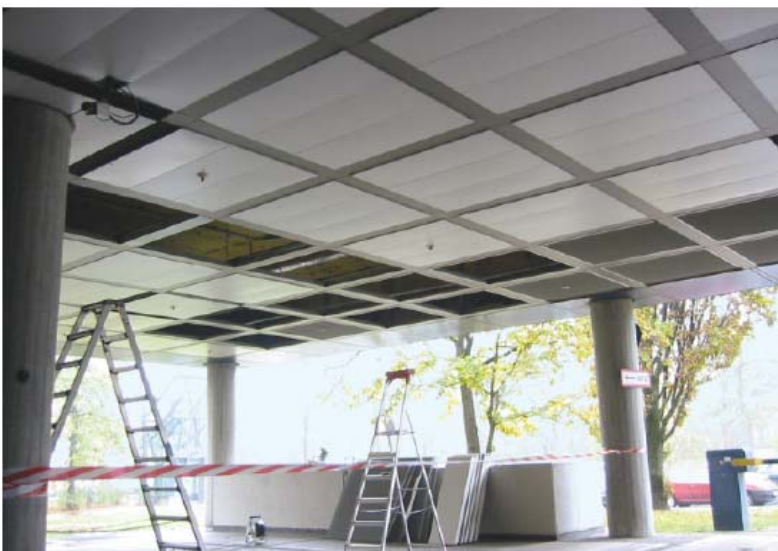
Bild 4 Ansicht einer abgehängten Decke EG/OG über einer ebenerdigen Tiefgarageneinfahrt, mit geöffneten Deckenfeldern. Das Erdgeschoß ist in diesem Bereich komplett offen. Die mittlere Betonstütze stellt eine Durchdringung der Dämmschicht im Eckbereich dar, die linke Betonstütze durchdringt die Dämmung innerhalb der Fläche der Decke, die rechte Stütze an der Kante zwischen Decke und Außenwand. Quelle: [5].
