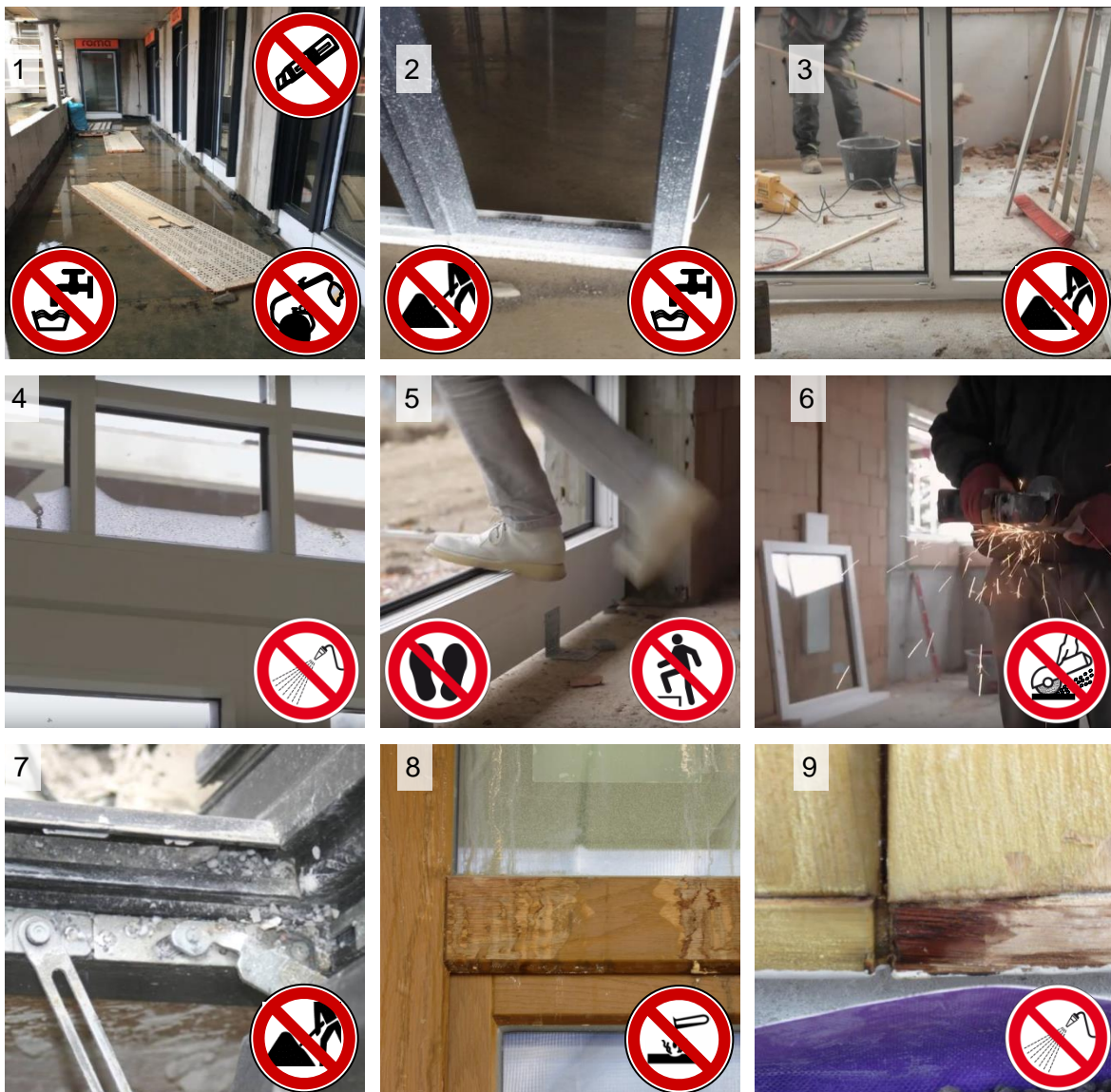
Bild 5 Gefahren im Baustellenalltag mit hohem Schadenrisiko (Bildreihe oben, Mitte) und Beispiele von Totalschäden durch außergewöhnliche Belastungen in der „nassen“ Bauphase (Bildreihe unten) (Quellen: Bilder 1 und 2: Fa. Hilzinger GmbH, Bilder 3 bis 6: Fa. Döpfner Betriebs GmbH & Co. KG, Bilder 7 bis 9: ift Rosenheim GmbH)
