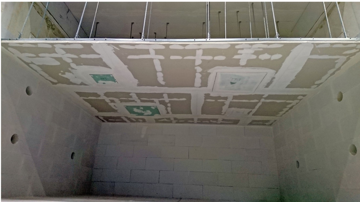
Bild 1 Revisionsöffnungsverschlüsse in einer Unterdecke (Quelle: ift Rosenheim)
