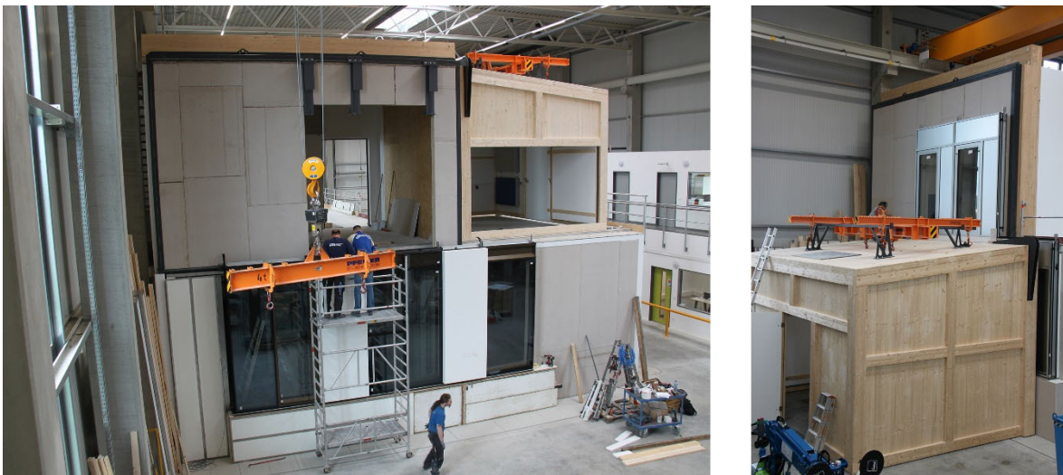
Bild 3 Neues ift-Schall-Labor zur Prüfung von Bauelementen bis zu einer max. Abmessung von 11 m × 12 m auf Luft-/Trittschall, Flankenschallübertragung nach nationalen, europäischen und amerikanischen Normen
