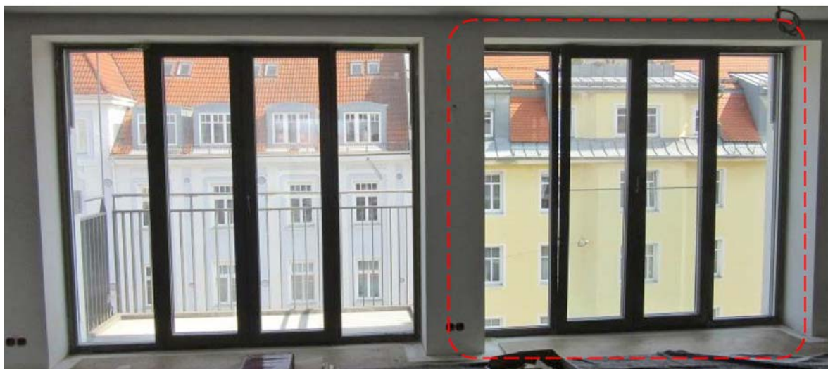
Bild 4 Gleiches Fenster, aber unterschiedliche Einbausituationen und daraus resultierende Anforderungen (links mit Balkon und Geländer, rechts mit französischem Balkon am Fensterelement = absturzsicherndes Fenster)
