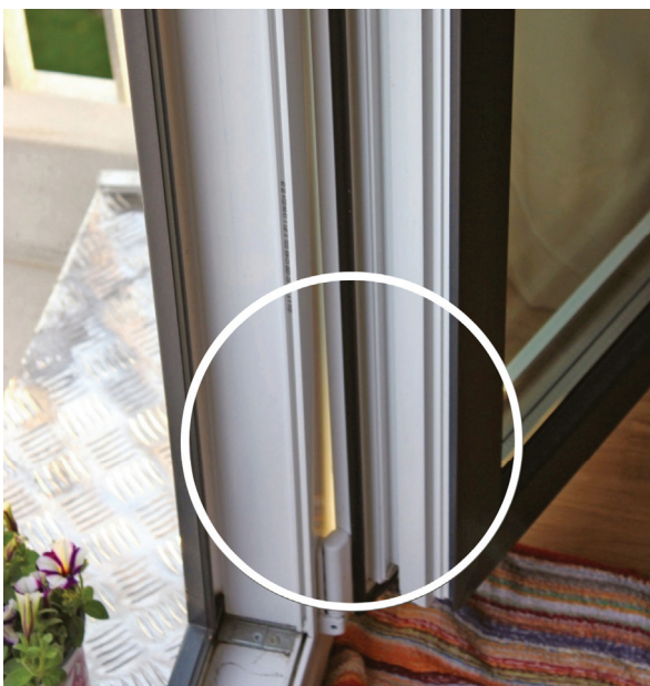
Bild 3 Aufgrund Differenzklima verformter Fensterflügel (siehe Lichtspalt) mit Einschränkungen bei der Bedienung
