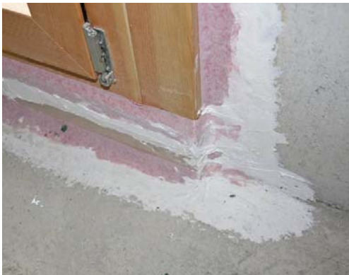
Bild 4 Typische Verarbeitungsfehler mit Dichtbändern (Zu straffer Verlauf des Dichtbands → langsame Ablösung vom Blendrahmen durch Zug auf die Klebung. Unsachgemäße Verwendung von Kleb-Dichtstoff zum Überspachteln des Übergangs zum Beton → Haftung zum Beton wird nicht verbessert und Putzarbeiten durch mit Kleb-/Dichtstoff bedeckte Flächen erschwert)
