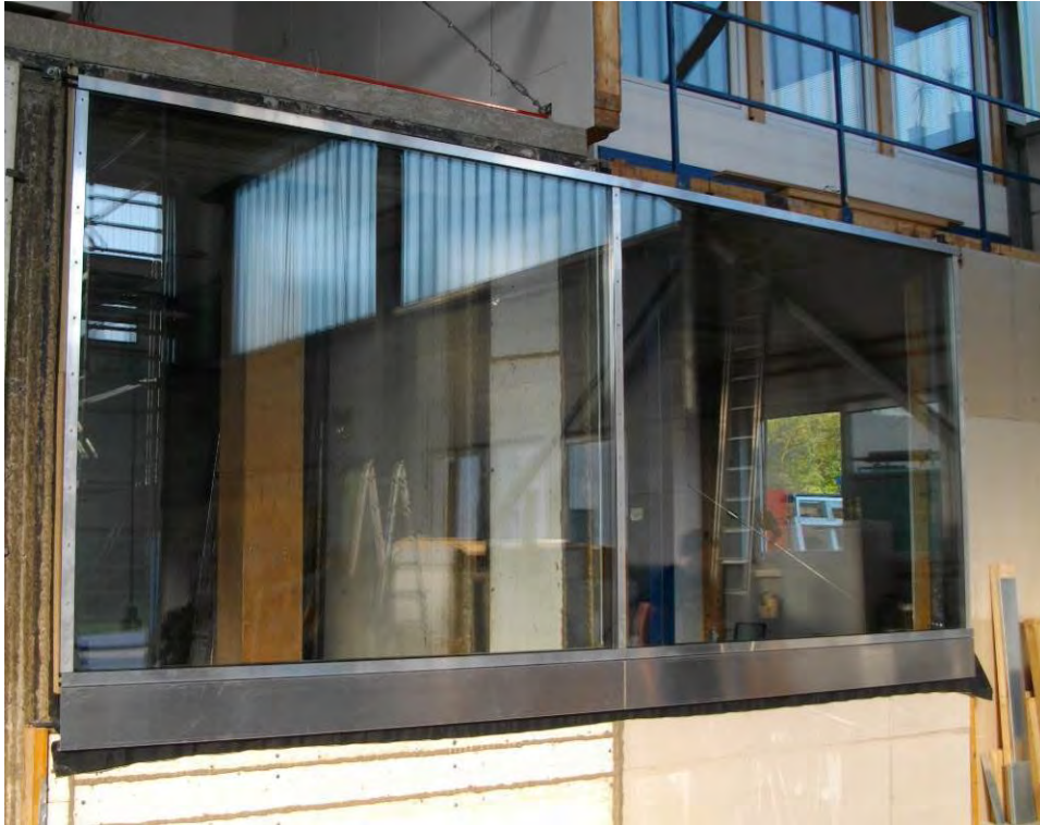
Bild A 5 Beispiel für eine Pfosten-Riegel-Fassade ohne Einselelement im Großformat, (Bildquelle: ift Vorgang 11-002583)
