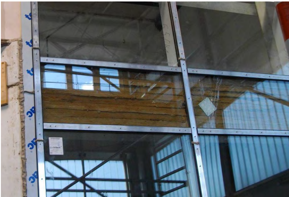
Bild A 72 Detailfoto der Pfosten-Riegel-Fassade, Hohlraumdämmung mit liegender Faser (senkrecht zur Schallübertragungsrichtung).
