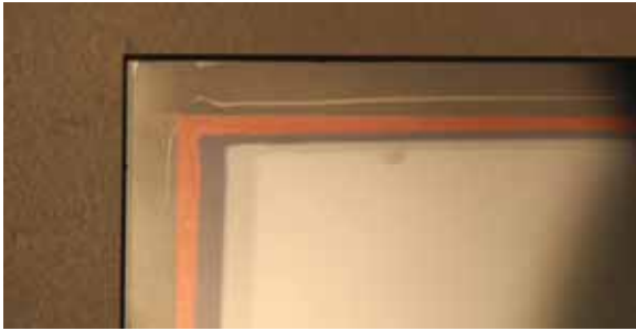
Abbildung 15 Lufteinschluss (grau) entlang der dem Sekundärdichtstoff zugewandten Schräge des Abstandhalters
