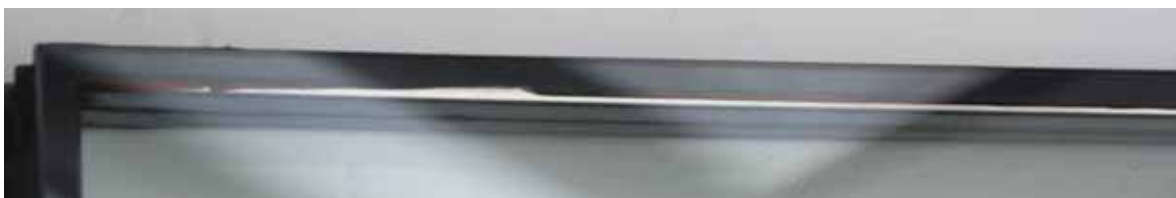
Abbildung 12 Unzureichender Butylauftrag auf Abstandhalter
