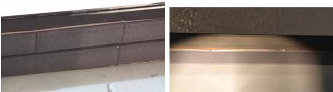
Abbildung 27 Der Abstandhalter war zu kurz, es wurde ein kurzes zusätzliches Stück mit zwei Längsverbindern eingefügt. Die Draufsicht zeigt, dass die Butylierung ungenügend war.
