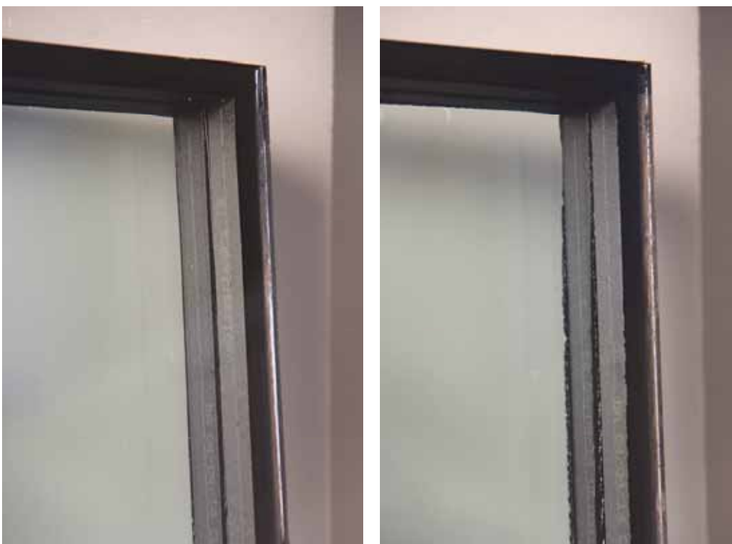
Abbildung 20 Probekörper wie in Abbildung 19: links im Lieferzustand, rechts nach Klimaalterung. In der Mitte der langen Kante ist mehr Butyl in den SZR gepresst worden als in der Ecke.
