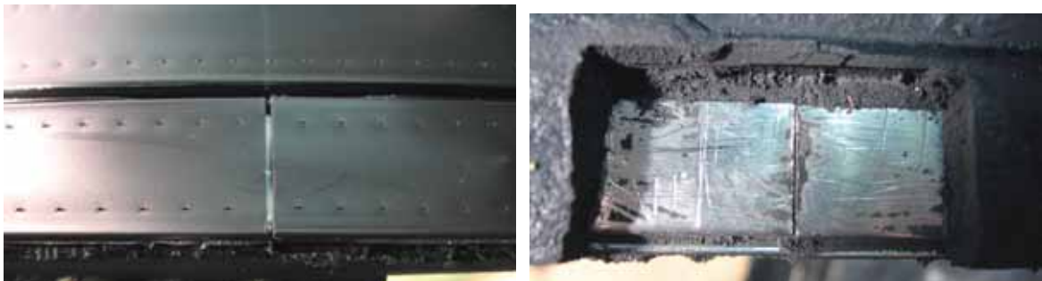
Abbildung 28 Eine große Lücke an der Verbindungsstelle, keine Butylierung auf der Rückseite
