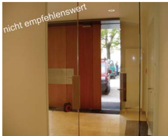
Bild 9 Schwer erkennbare Glastüren (Tür im Windfang eines Mehrfamilienhauses)
