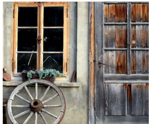
Bild 1 Fenster mit Einfachglas; hier lohnt sich die energetische Sanierung! Fotoquelle: © Tobias Kunze / PIXELIO www.pixelio.de
