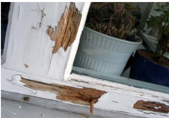
Bild 2 Stark beschädigte Fensterprofile machen einen Komplettaustausch (s. Kapitel 4.3) erforderlich. Fotoquelle: © ift Rosenheim
