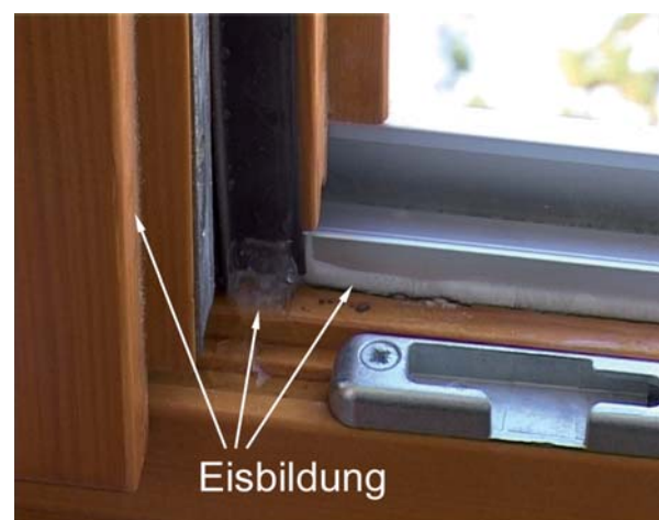
Bild 4 Tauwasser bis hin zur Eisbildung im Fensterfals kann durch eine möglichst luftdichte raumseitig angeordnete Dichtebene entgegengewirkt werden. Fotoquelle: © ift Rosenheim
