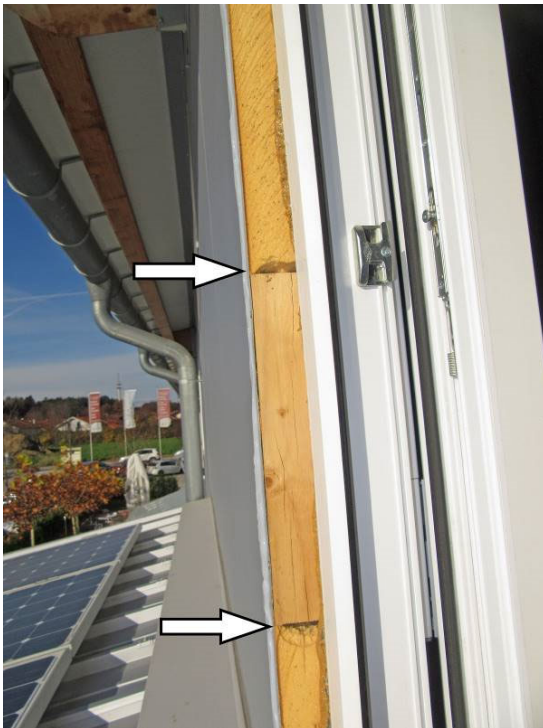
Bild 2 Durch den Fensterlieferanten abschnittsweise ins Paneel eingefügtes Holzteil (s. Pfeile) für die Anbindung der Fenster. Das Paneel ist nicht in der Lage, Lasten aufzunehmen.
