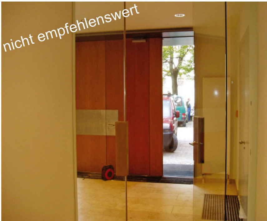
Bild 3 Eine Glastür ohne Sicherheitsmarkierungen stellt in Hinblick auf ein mögliches „Dagegenlaufen“ eine Gefahrenstelle dar
