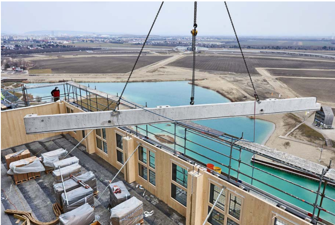
Bild 6 Vorgefertigte Fassadenelemente mit Fenstern in Holzfertigbauweise ermöglichen einen schnellen Baufortschritt und hohe Qualität beim 84 Meter hohen Holz-Hochhaus in Wien. (Quelle: Erich Weismann, Kommunikation Kerbler Holding GmbH, Wien)
