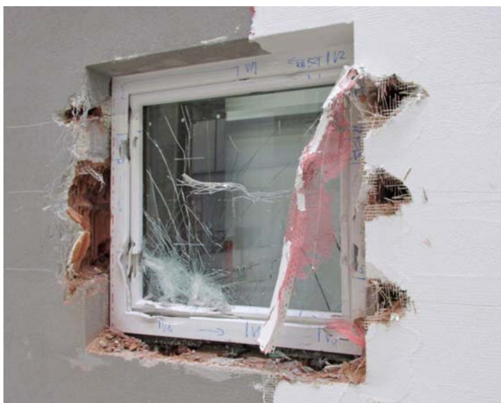
Bild 2 Fenster nach mehreren manuellen Angriffen in RC3.
