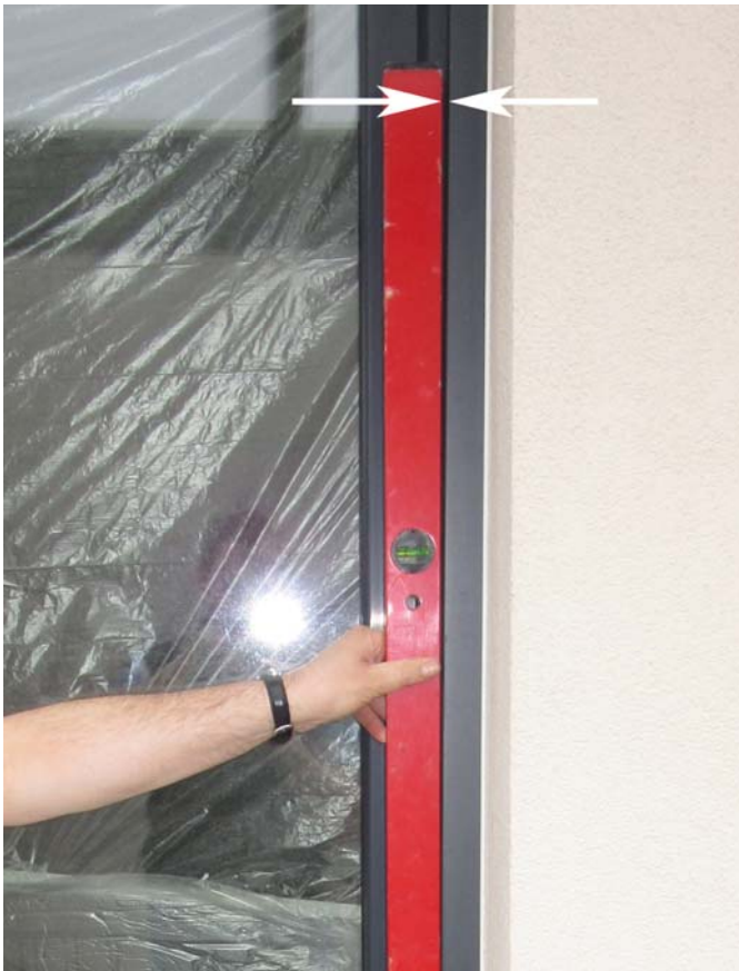
Bild 1 Deutliche Verformungen der Rolladenführungsschiene aufgrund thermischer Längenänderungen durch direkte Sonneneinstrahlung
