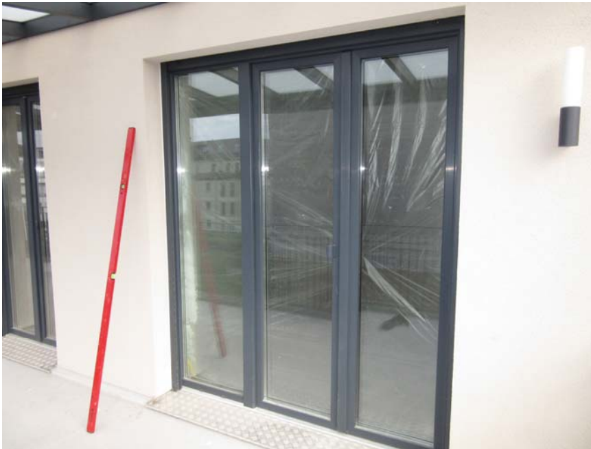
Bild 2 Typisches Ausführungsbeispiel von bodentiefen Fenstertüren aus Kunststofffensterprofilen mit dunkelgrauer Oberfläche und aufgesetzten Rolladenführungsschienen
