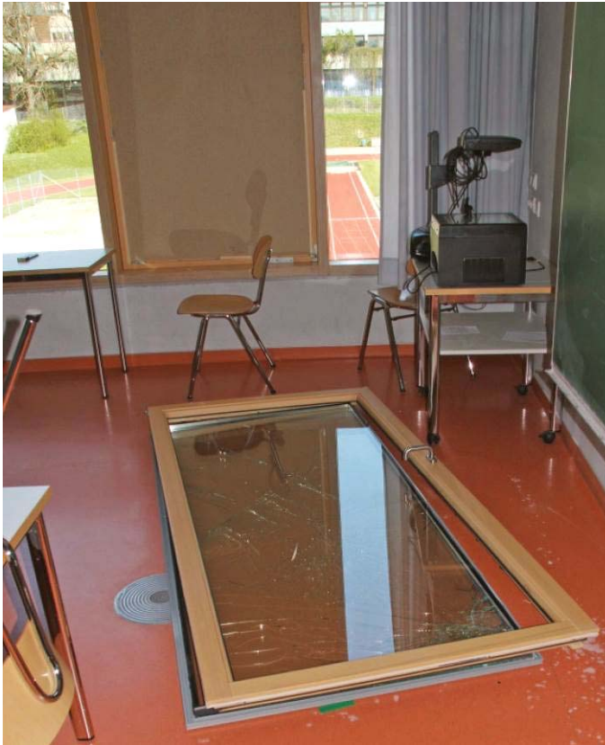
Bild 1 Damit Unfälle vermieden werden: besonders auf die richtige Beschlagsauswahl kommt es bei schweren Fensterflügelformaten an! (Quelle: ift Rosenheim)
