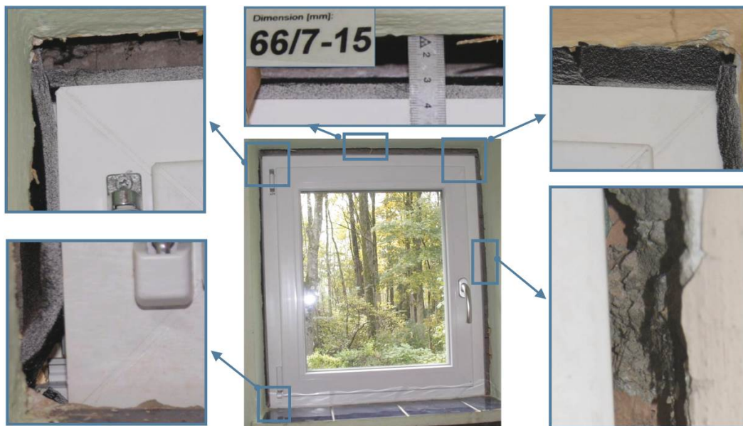
Bild 11 Fehlerhafte Ausführung der Abdichtung mittels Dichtband
