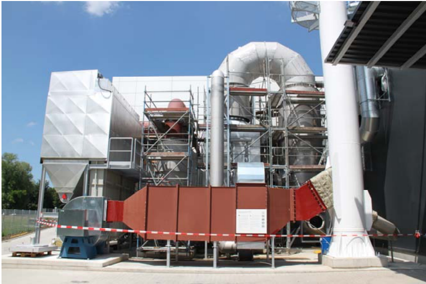
Bild 4 Bei der aufwendigen Rauchgasreinigungsanlage liegen die Emissionen durch modernste Umwelttechnik weit unter den Mindestwerten der TA Luft
