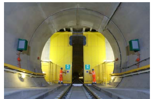
Die riesigen Tunnel Tore im neuen Gotthard Tunnel und die Sicherheitsprüfung vom ift Rosenheim
