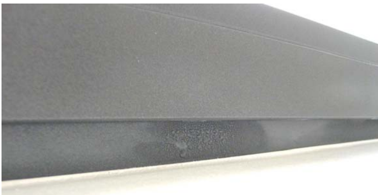
Bild 3 Stark begrenzte Tauwasserbildung an einem Aluminiumfenster deutet auf eine lokale Wärmebrücke im Anschlussbereich hin.
